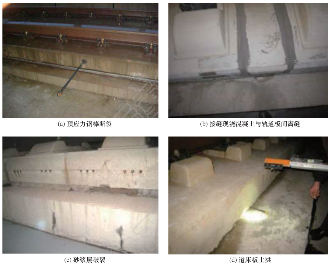
图7 无砟轨道伤损情况
